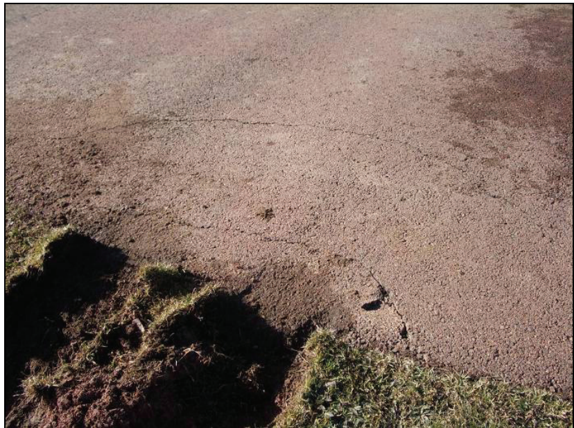
Photo 2. Vue des dommages en bordure du seuil de piste faits par le train droit
