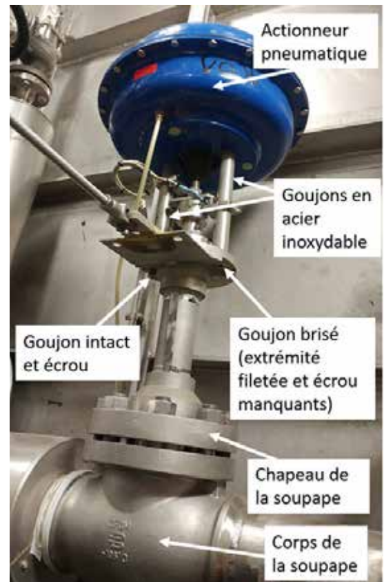
Figure 2. Soupape V08 sur le système d'alimentation en combustible au GNL à bâbord
