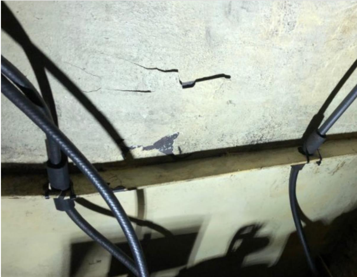
Figure 7. Dommages au couple structurel et à la cloison qui séparait le compartiment des batteries de la salle des machines (Source : Glory Days Towing Ltd.)
