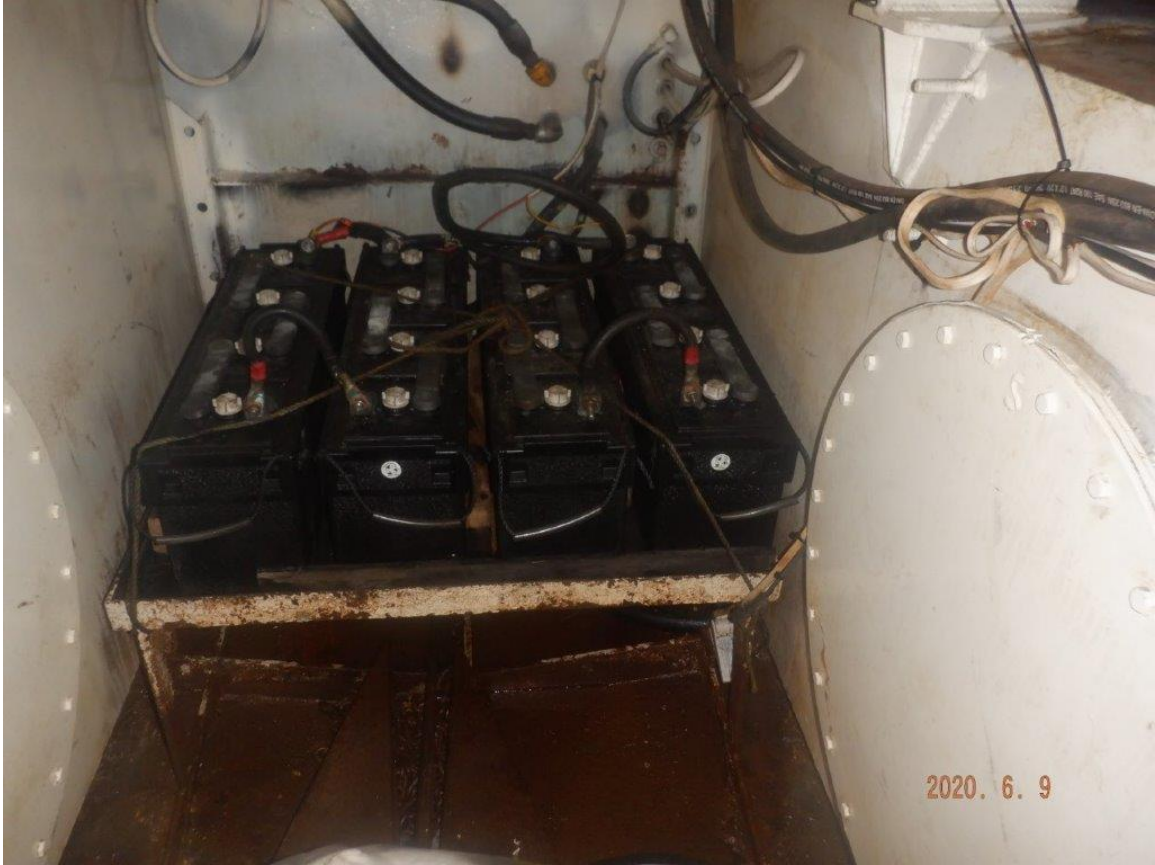
Figure 4. Photographie prise 2 mois avant l'événement qui illustre le groupe de 4 batteries de 8 V c.c. situé dans la partie avant de la cambuse entre les 2 réservoirs de carburant (Source : Accurate Appraisals & Marine Surveys Ltd.)
