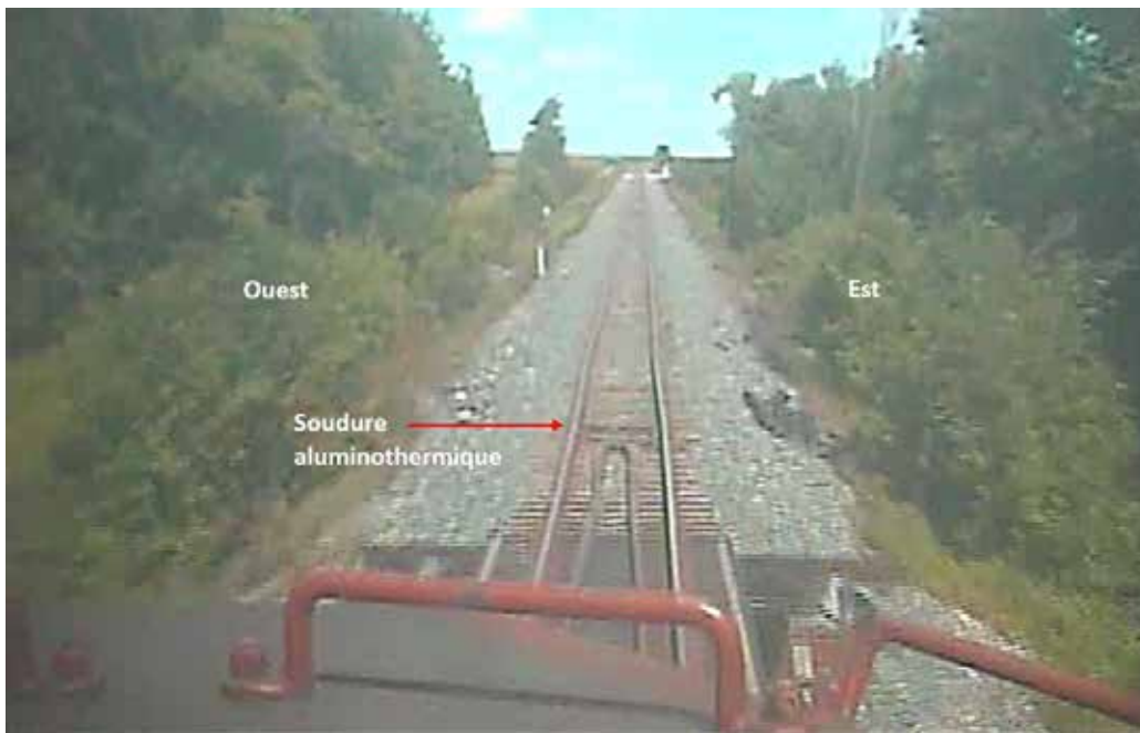
Figure 5. Soudure aluminothermique dans le rail gauche (ouest) juste après les contre-rails qui dépassaient de l'extrémité nord du pont (Source : Chemin de fer Canadien Pacifique, avec annotations du BST)
