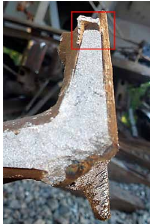
Figure 4. Plan rapproché de la surface de rupture de la soudure aluminothermique mettant en évidence le point d'origine
