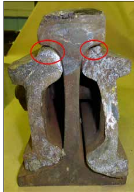
Figure 3. Joint de rail sud vu de l'est. Les signes de fatigue sont encerclés en rouge
