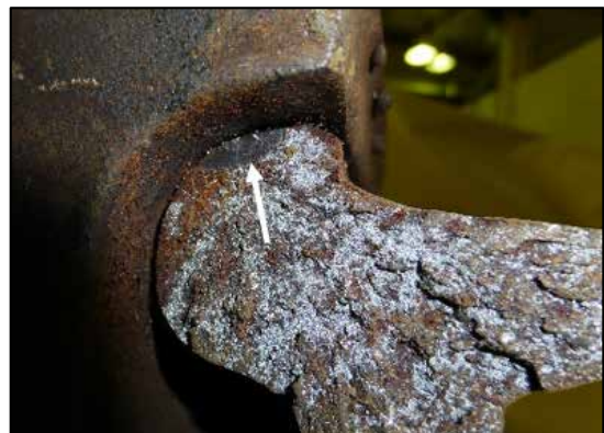
Figure 5. Côté extérieur de l'éclisse; la flèche indique les marques de fatigue
