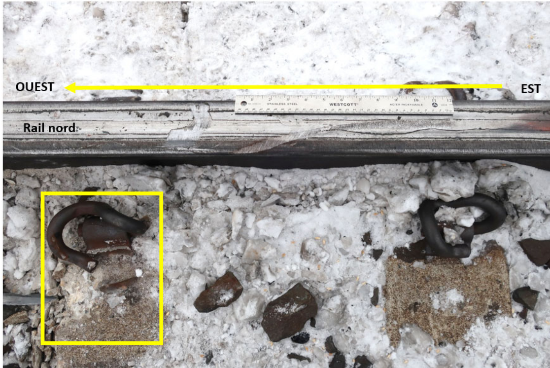
Figure 5. Marques de roue sur le dessus du rail nord, ainsi que l'attache de rail et la traverse endommagées du côté intérieur (dans l'encadré) au point milliaire 166,33 (Source : BST)
