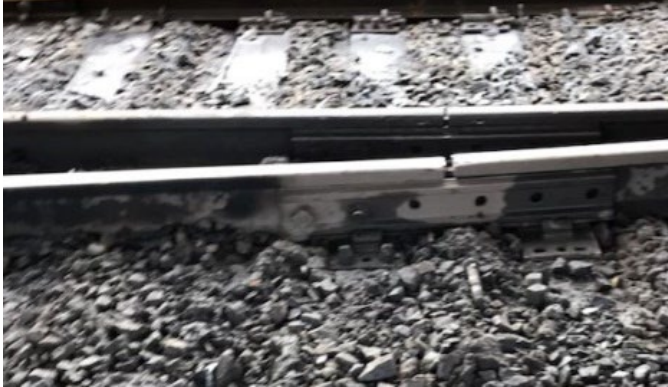
Figure 4. Rupture d'éclissage au point milliaire 116,67 (Source : Canadien Pacifique)
