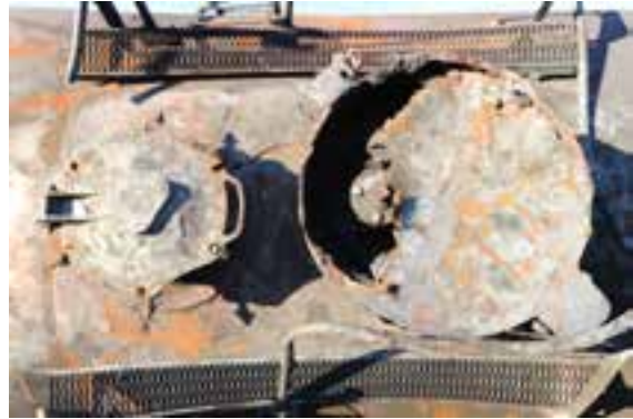
(d) Manway and top fittings
