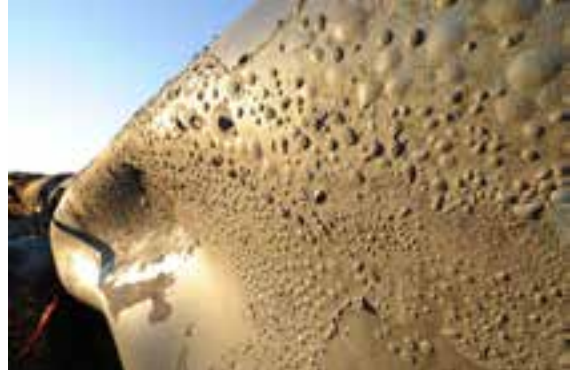
(d) Close-up showing blistering and metal loss on shell
