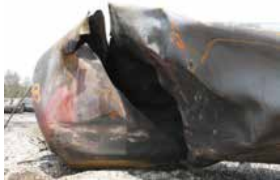
(d) Detail of shell rupture
