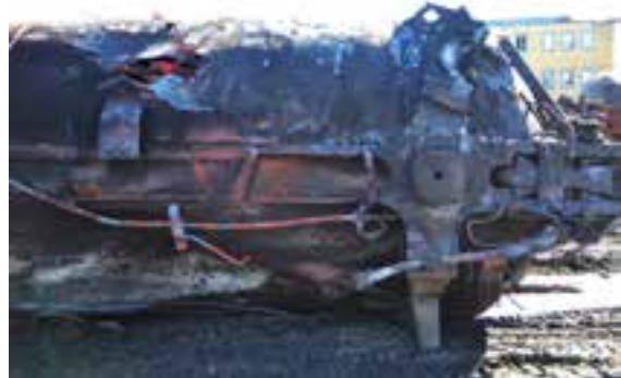
(d) Burn-through in shell (RSI-AAR Safety Project photo)
