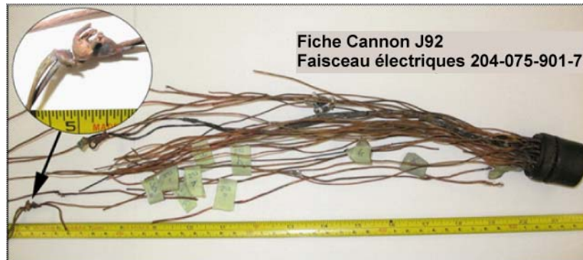
Photo 4. Gros plan du faisceau de fils 204-075-901-7 montrant les dommages causés par les arcs électriques.
