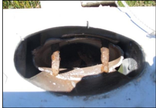
Photo 5. Boulons traversants corrodés
