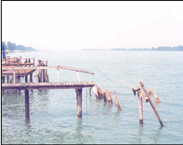
Photo 5. Quai privé endommagé
