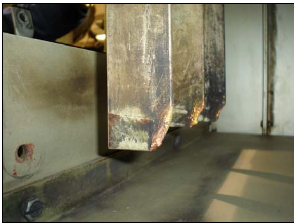
Photo 12. Vue de l'extrémité des barres omnibus montrant le résultat d'un arc électrique.
