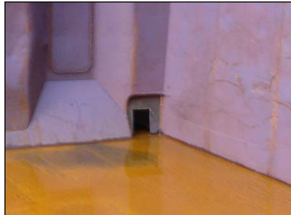
Photo 4. Ouverture d'assèchement de la cloison non étanche
