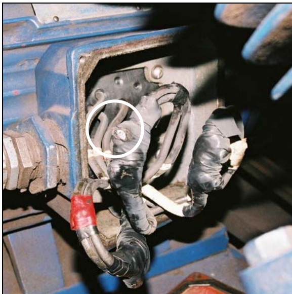
Photo 15. Fil électrique recouvert de ruban isolant où l'on peut voir une vis nue.
