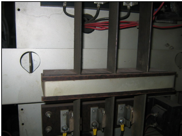
Photo 7. Vue latérale de la disposition normale des trois barres omnibus verticales reposant sur un isolant en bakélite et fixées par le support en acier
