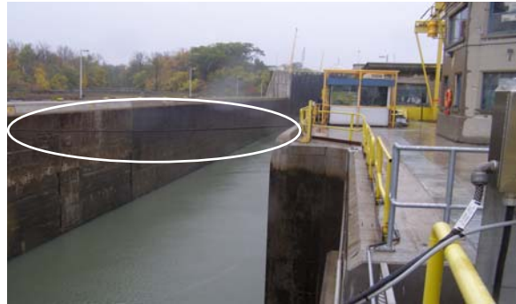
Photo 5. Vue de jour du sas est de l'écluse 4 avec le câble d'arrêt abaissé (encerclé sur la photo).
