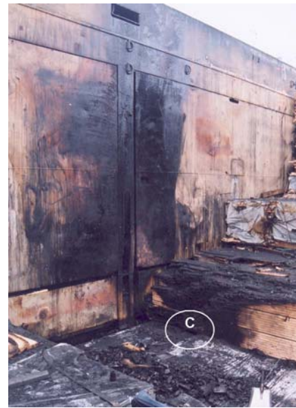
Photo 3. Premier foyer d'incendie
