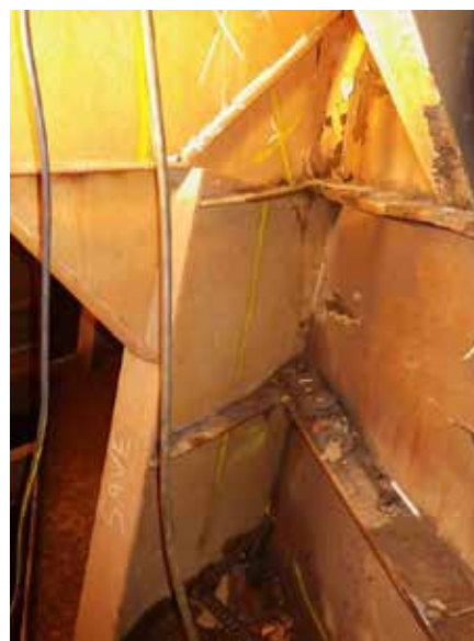
Figure 3. Avaries au coqueron avant
