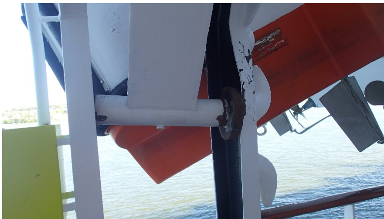
Figure 11. Dommages causés au rail à galets arrière du bossoir de l'embarcation de sauvetage n° 4 (Source : BST)
