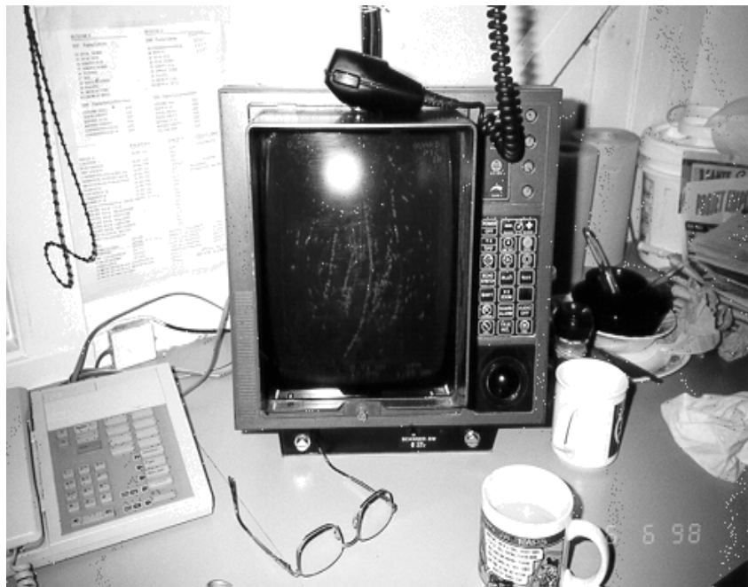
cran radar install dans les locaux du pontier
