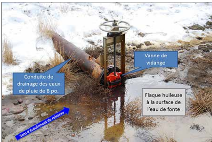
Figure 4. Conduite de drainage des eaux de pluie avec la vanne de vidange
