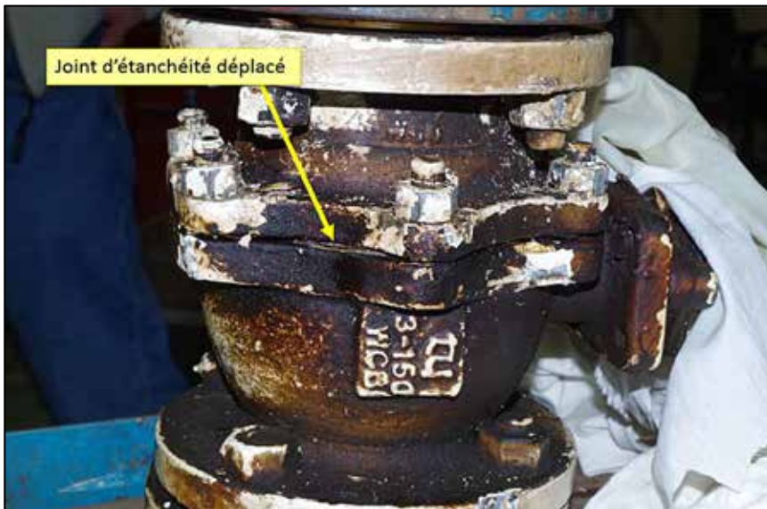
Figure 9. Joint d'étanchéité déplacé (Source : Acuren Group Inc., avec annotations du BST)
