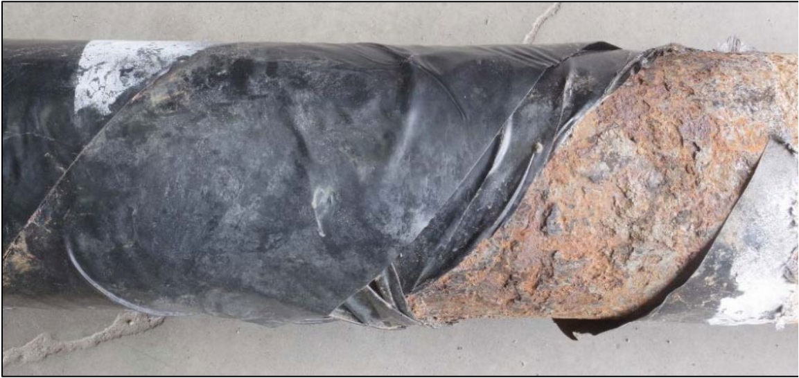
Figure 9. État de la surface externe de la conduite après l'événement (Source : Acuren Group Inc.)
