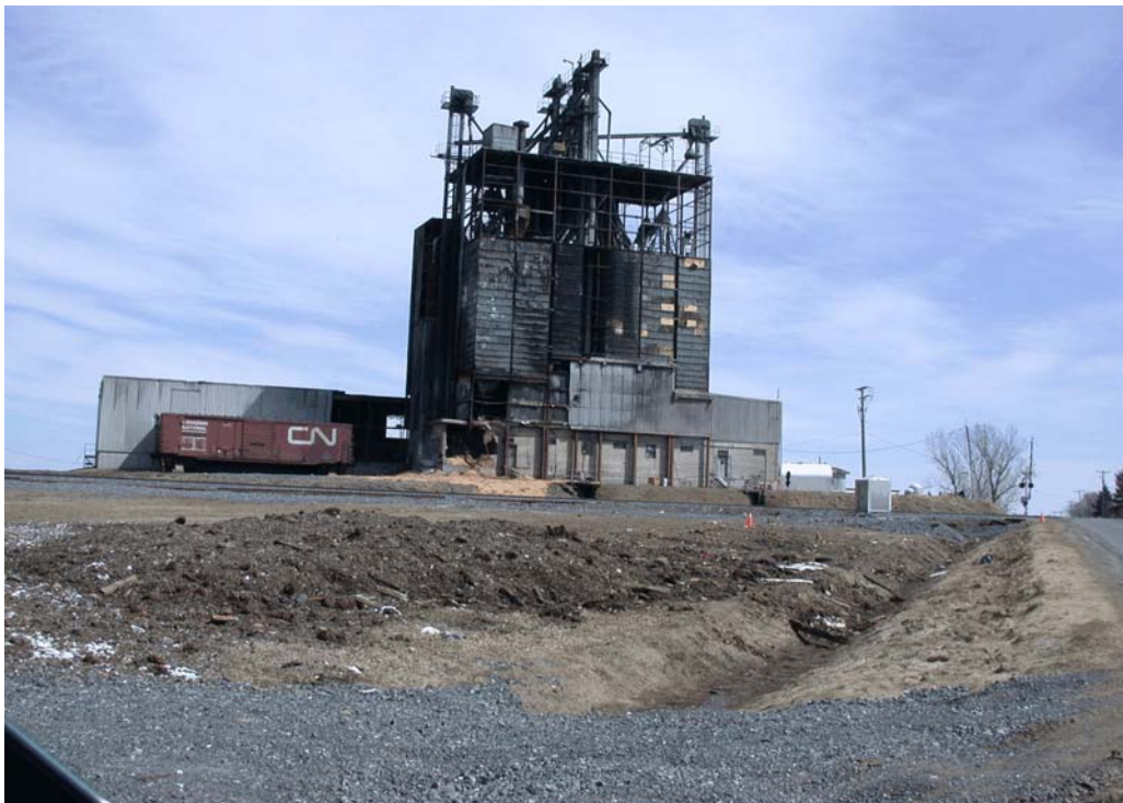
Photo 1. Façade endommagée de la meunerie (photo prise deux mois après l'accident)
