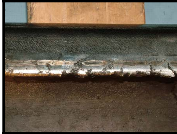
Photo 8. Face intérieure du rail montrant des signes d'éraflures et de déchirures
