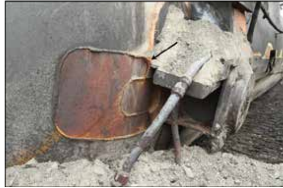
Photo 18. Longrine centrale tronquée endommagée
