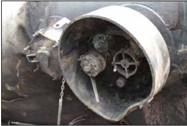
Photo 21. Enceinte protectrice conçue pour assurer la protection des discontinuités des raccords supérieurs de wagon-citerne (couvercle enlevé)
