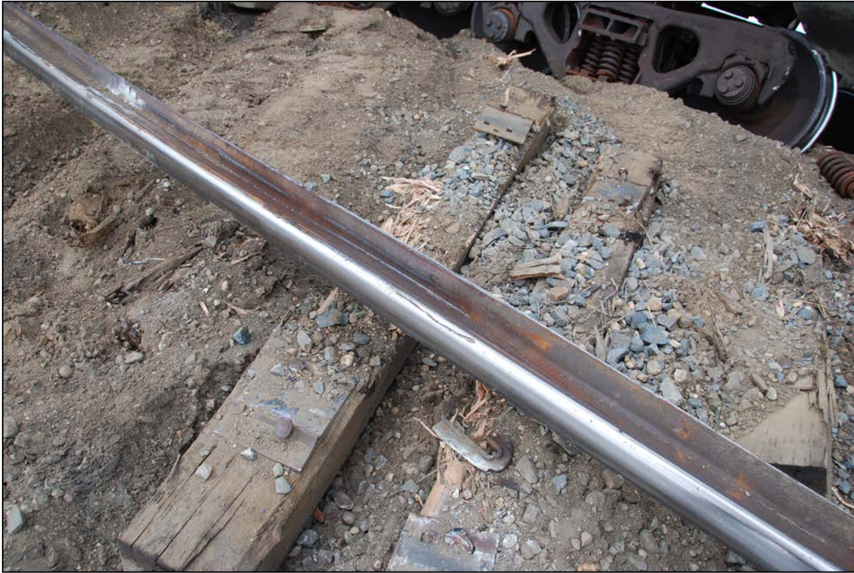
Photo 5 . État de la plate-forme et du ballast près du PDD
