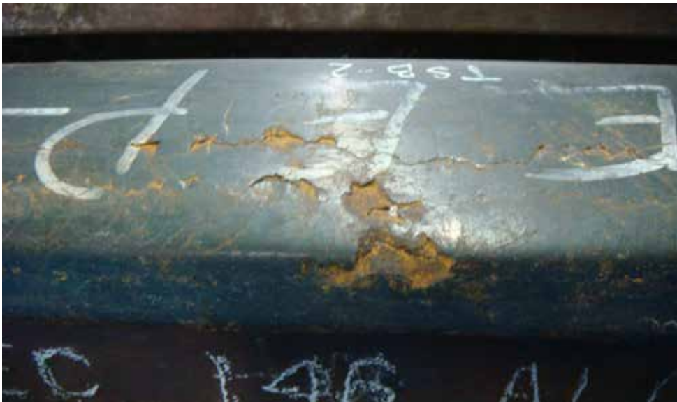
Photo 6. Condition de la surface du rail
