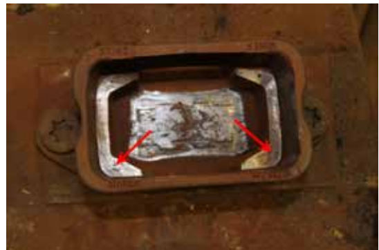
Photo 6. Cage du glissoir à contact permanent du côté gauche. Les flèches pointent vers les zones usées où la partie métallique du CCSB a fait contact avec la cage.
