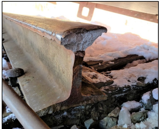
Figure 3. Rail de remploi rompu au point milliaire 103,73 (Source : BST)
