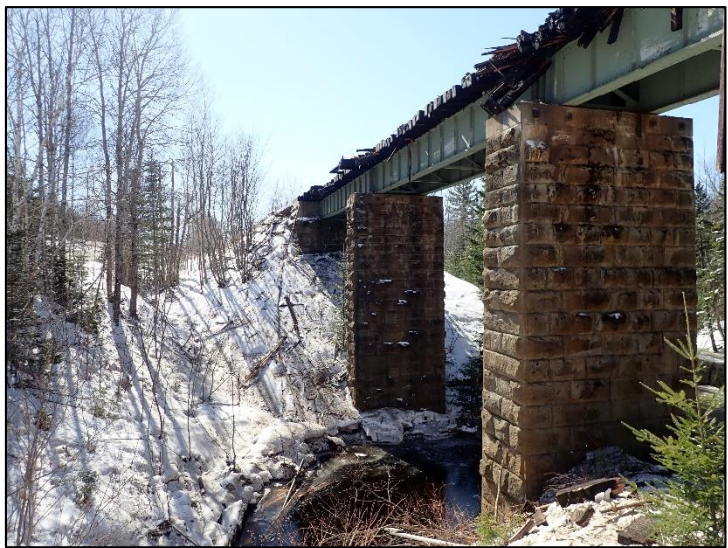
Figure 5. Pont au point milliaire 14,9 avec des selles endommagées (Source : BST)
