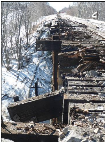
Figure 4. Dommages au tablier du pont (Source : BST)
