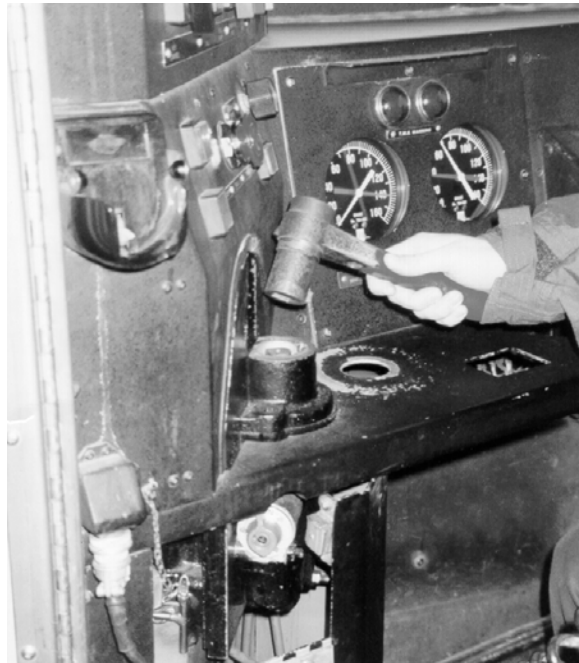
Figure 2 - Intérieur du poste de commande de la voiture cabine de commande Le robinet de mécanicien et l'endroit où doit être rangée la poignée sont indiqués par des flèches.
